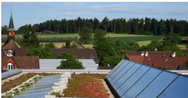
Aussicht vom Dach mit den Sonnenkollektoren
